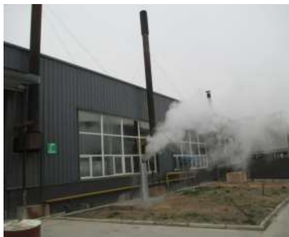
B05 天然气锅炉排气筒
