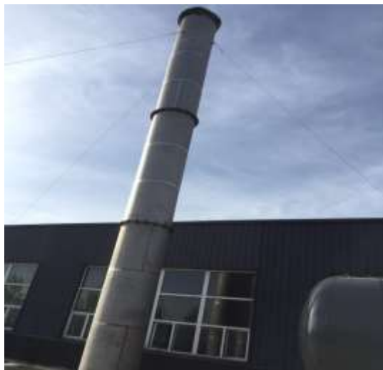
B03 天然气锅炉排气筒
