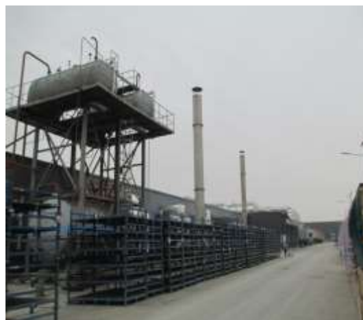
B02 天然气锅炉排气筒
